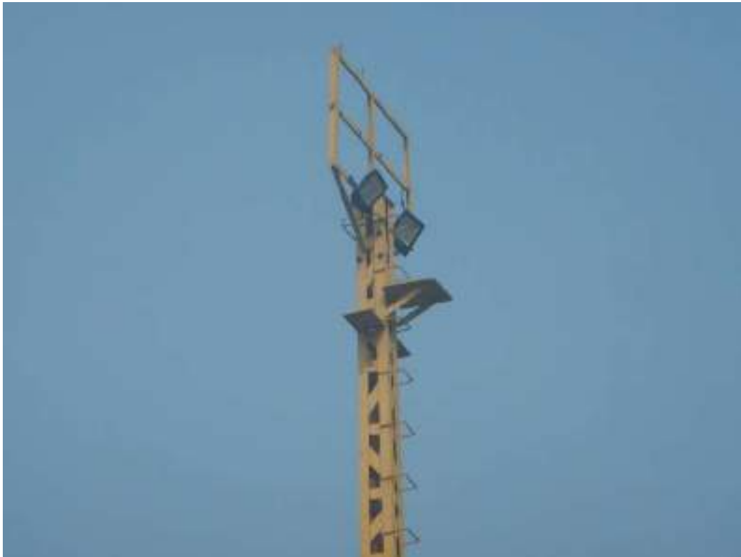
FIGURA 258 – SISTEMA DE ILUMINAÇÃO DO PORTO. FONTE: UNILIVRE, SETEMBRO, 2023.
