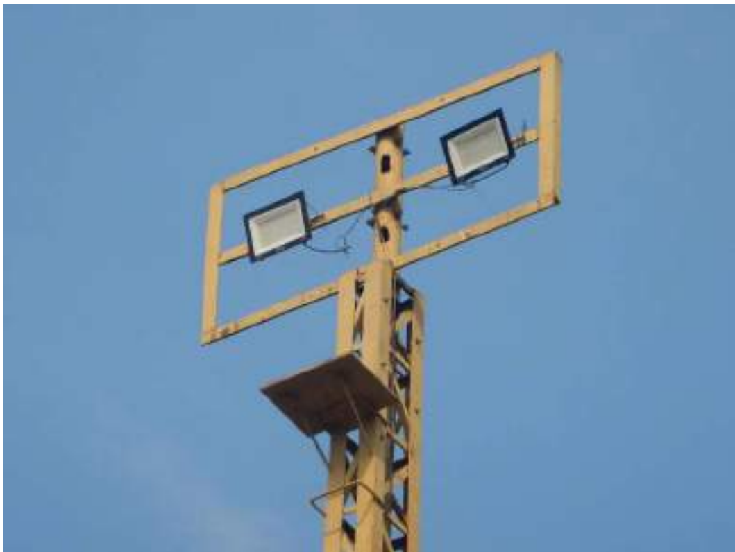
FIGURA 259 – SISTEMA DE ILUMINAÇÃO DO PORTO. FONTE: UNILIVRE, SETEMBRO, 2023.
