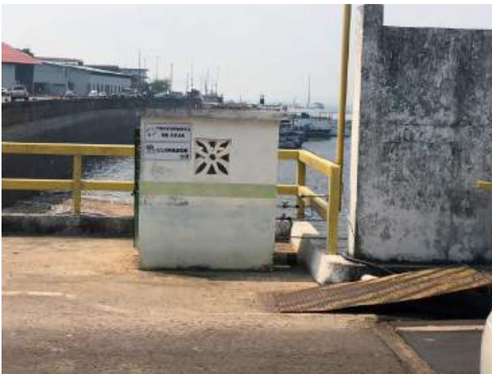
FIGURA 194 – CENTRAL DE TRATAMENTO DE ÁGUA NA PONTE ROADWAY. FONTE: UNILIVRE, SETEMBRO, 2023.
