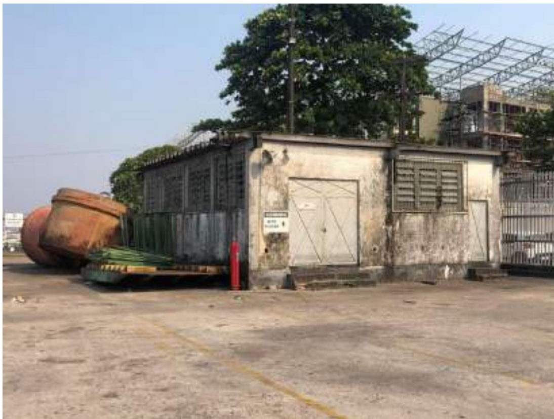
FIGURA 188 – SUBESTAÇÃO DE ENERGIA LOCALIZADA NA PLATAFORMA MALCHER. FONTE: UNILIVRE, SETEMBRO, 2023.
