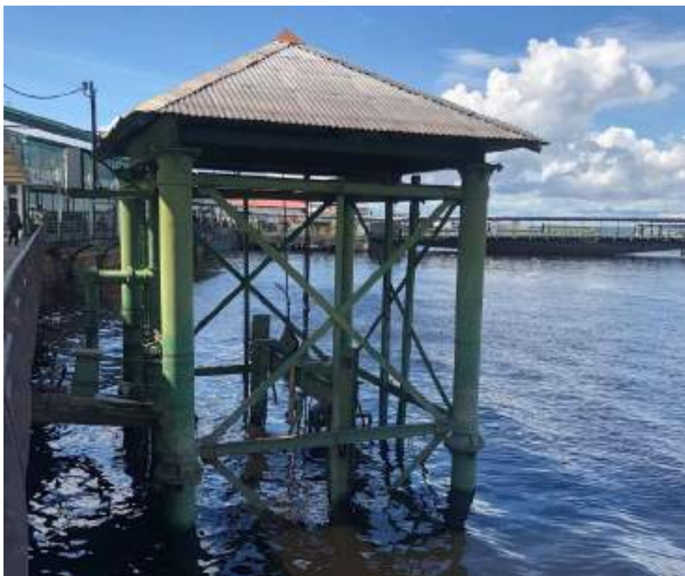
FIGURA 223 – BOMBA D'ÁGUA. FONTE: UNILIVRE, MAIO, 2023.
