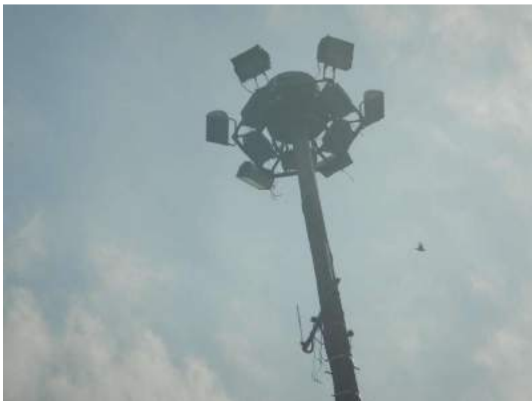
FIGURA 257 – SISTEMA DE ILUMINAÇÃO DO PORTO. FONTE: UNILIVRE, SETEMBRO, 2023.
