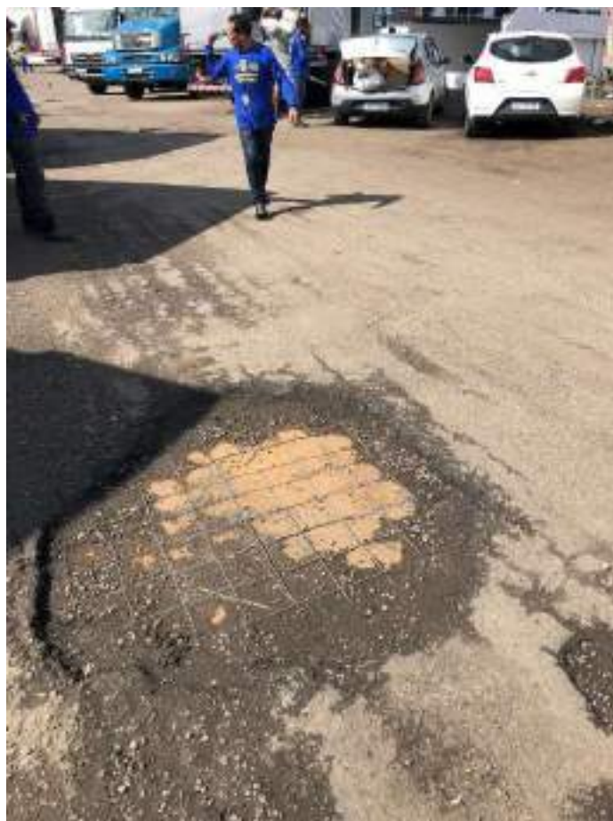
FIGURA 254 – SITUAÇÃO DO PAVIMENTO DO CAIS FLUTUANTE ROADWAY. FONTE: UNILIVRE, MAIO, 2023.
