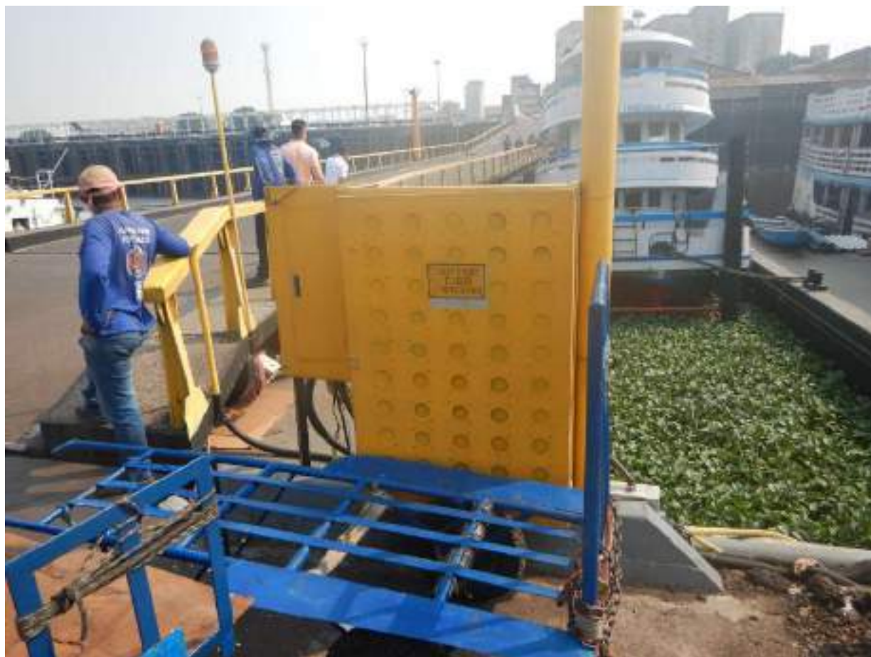
FIGURA 186 – QUADRO DE ENERGIA NO CAIS DAS TORRES. FONTE: UNILIVRE, SETEMBRO, 2023.
