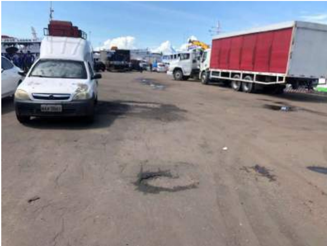
FIGURA 255 – SITUAÇÃO DO PAVIMENTO DO CAIS FLUTUANTE TORRES. FONTE: UNILIVRE, MAIO, 2023.
