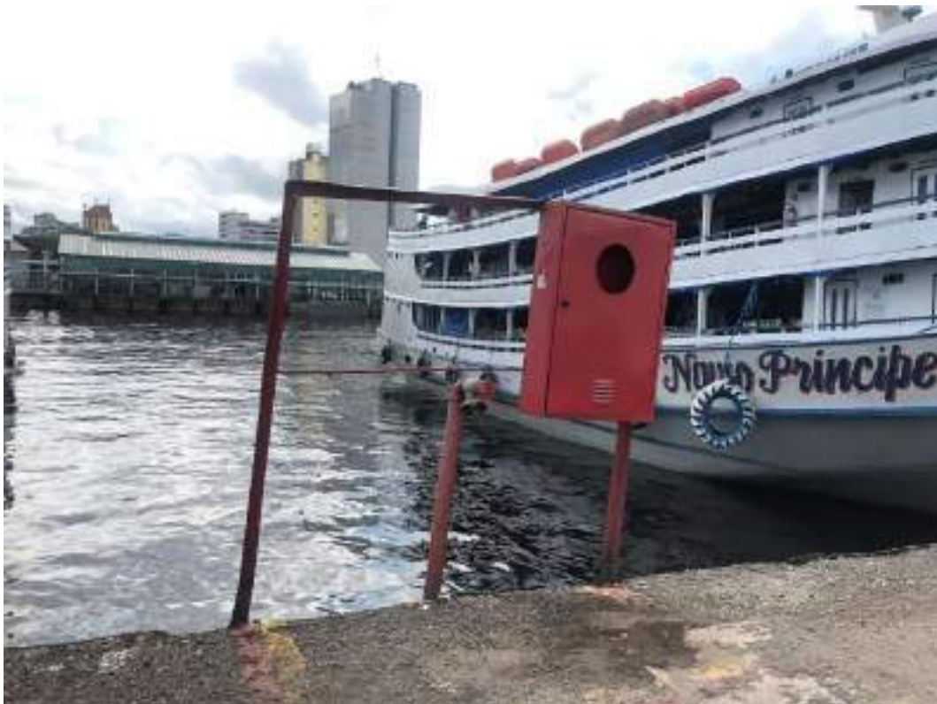
FIGURA 256 – SISTEMA DE COMBATE A INCÊNDIOS DO FLUTUANTE ROADWAY. FONTE: UNILIVRE, MAIO, 2023.
