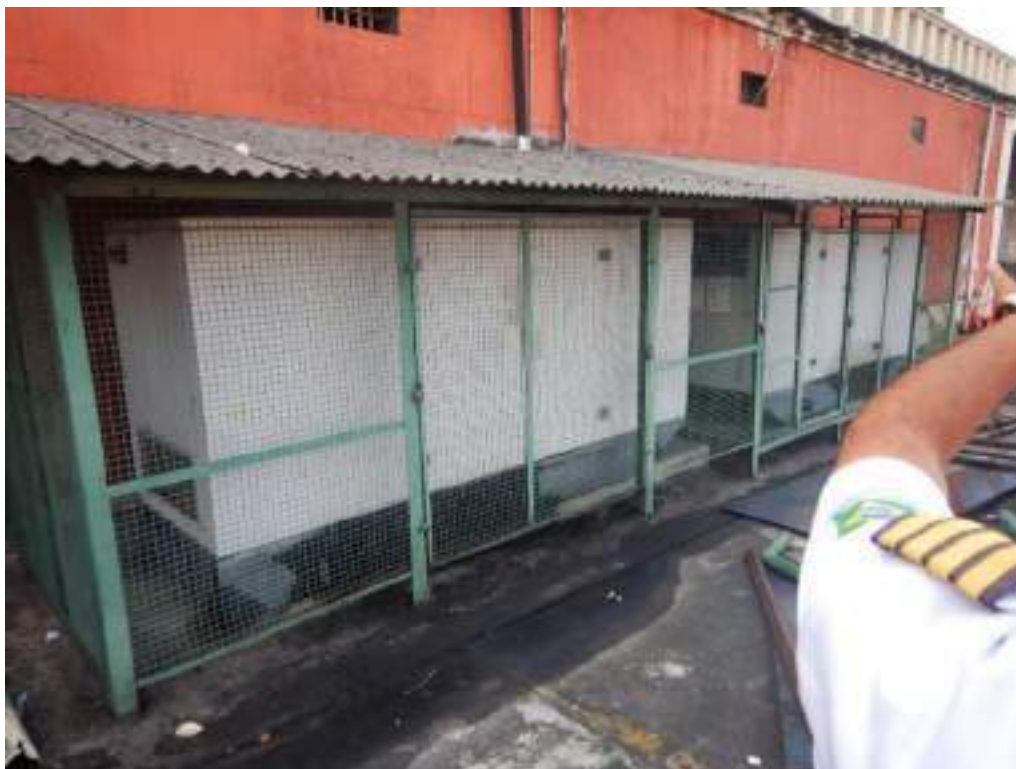
FIGURA 190 – GERADORES LOCALIZADOS NA PLATAFORMA MALCHER AO LADO DO PRÉDIO DA ADMINISTRAÇÃO. FONTE: UNILIVRE, SETEMBRO, 2023.
