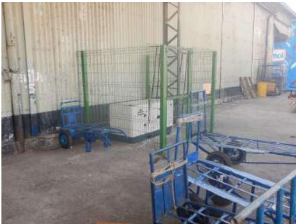
FIGURA 191 – GERADOR DE ENERGIA AO LADO DO ARMAZÉM Nº 3. FONTE: UNILIVRE, SETEMBRO, 2023.
